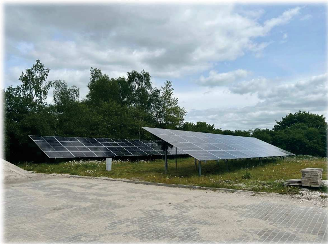
Instalacja fotowoltaiczna dla oczyszczalni ścieków.
